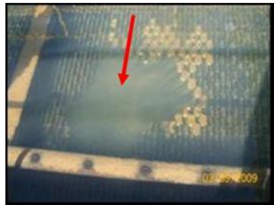
Figura 7 - Módulos faltando na ETA
