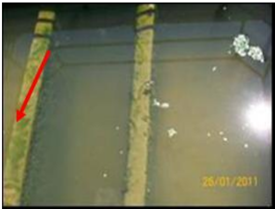
Figura 6 - Acúmulo de lodo no decantador da ETA
