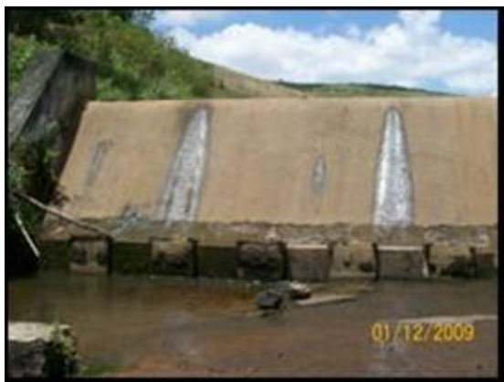
Figura 1 - Parede da barragem com infiltrações
