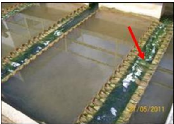
Figura 8 - Excesso de lodo nas calhas dos filtros da ETA
