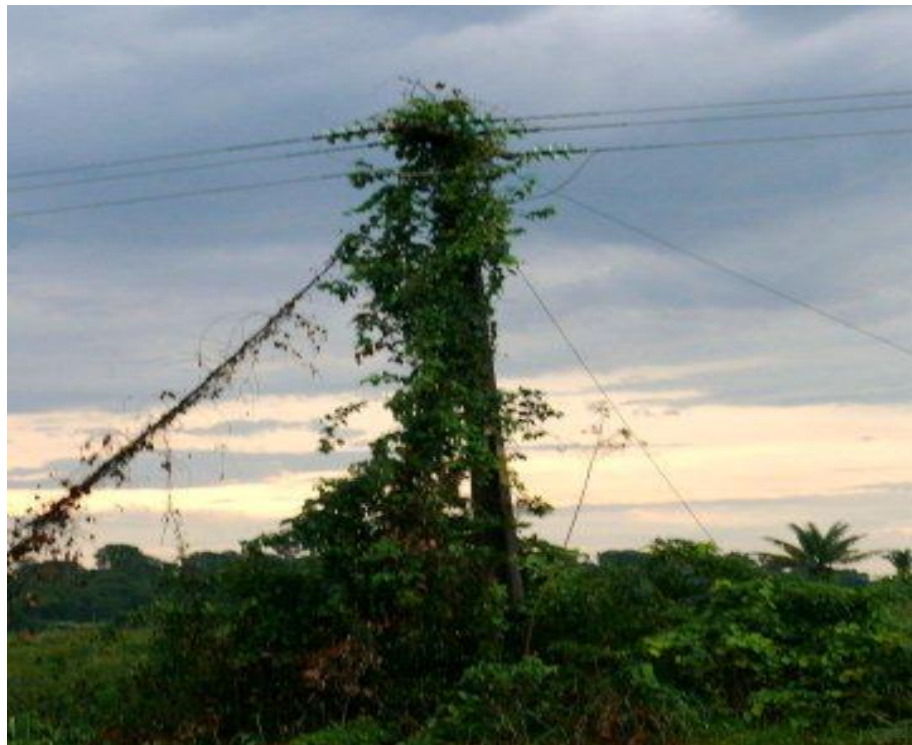
Figura 9.2. – Vegetação encobrindo estrutura
