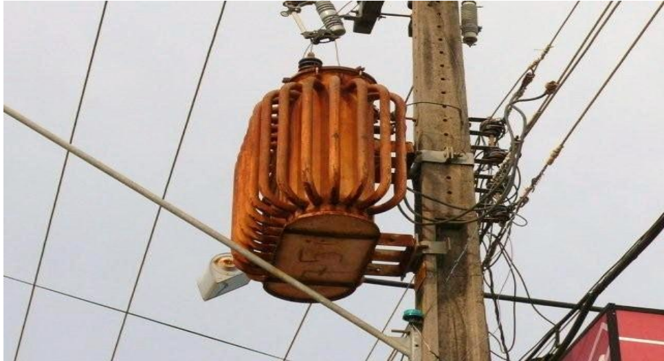
Figura 9.1. – Transformador em mau estado
