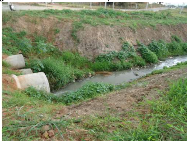
Figura 11 – Lançamento inadequado no meio ambiente
