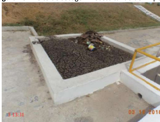
Figura 10 – Leito de secagem necessitando de limpeza
